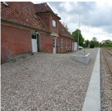
Det kan ses, at fugemateriale mangler i muren.
