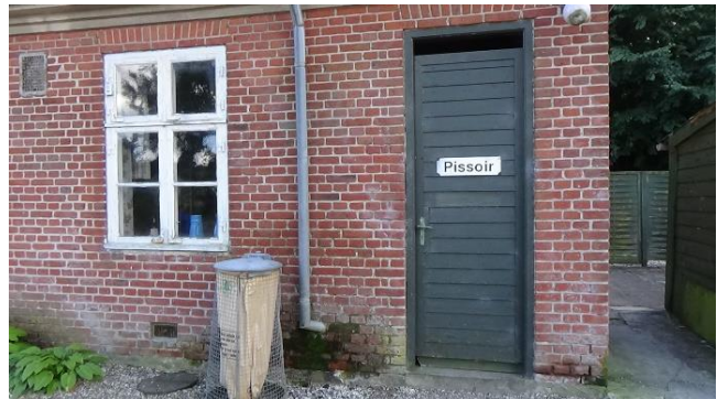
Pissior der gennemskylles af regnvand. Bemærk de manglende fuger.
