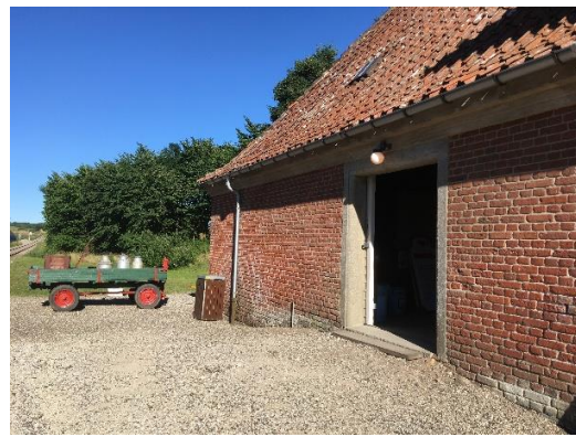
Fugerne trænger til nyt mørtel
