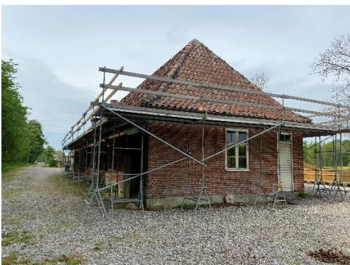
Den østlige gavl mangler fugemateriale
